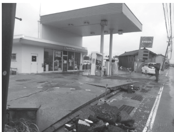
写真1 令和6年能登半島地震の際に発生した給油取扱所の地下タンクの浮き上がり
