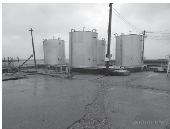
写真2 令和6年能登半島地震の際に発生した基礎・地盤の変状による屋外貯蔵タンクの傾斜
